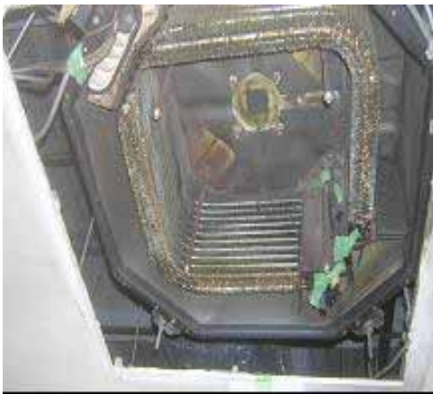
室内機の洗浄前
